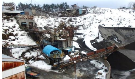
プラント稼働状況
